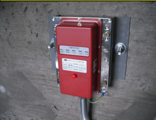
機械室(地震感知器)
