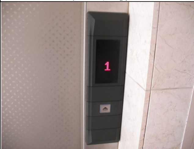
1階ホールインジケータ
