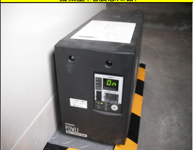
機械室(停電時管制装置)
