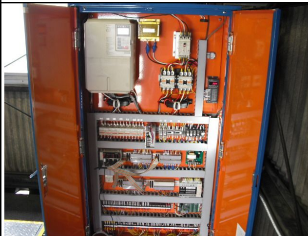
機械室(制御盤)
