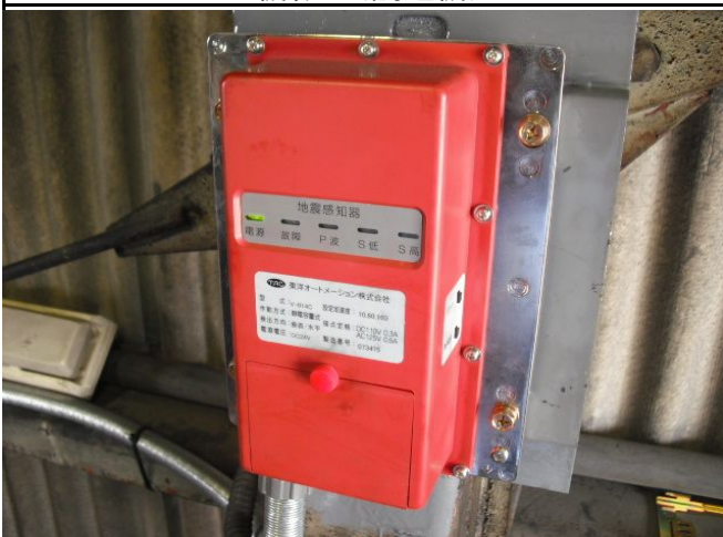
機械室(地震感知器)
