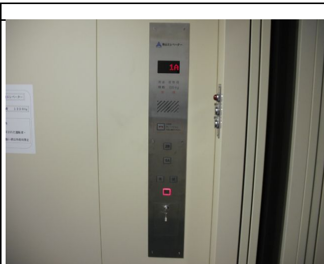
かご内操作盤
